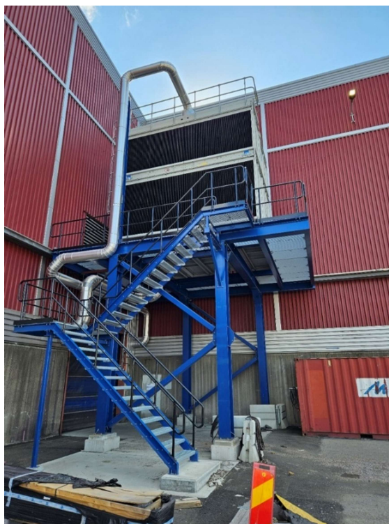
Figur 18, kylare för överskottsvärme vid Ovako, 20 MW elektrolysinstallation i Hofors, Sverige.
