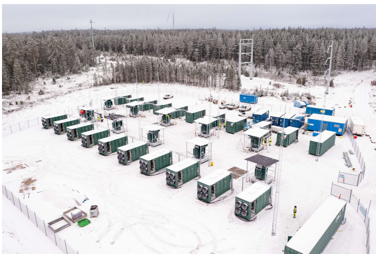
Figur 20, 42,5 MWh batterilagringssystem, byggt av OX2, i Bredhälla, Sverige.
