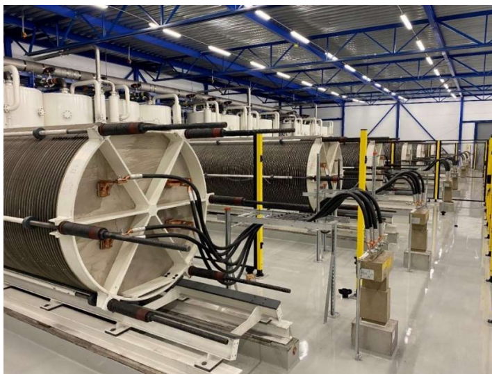
Figur 16, 6 x 2,5 MW AEL elektrolysörer installerade vid Ovako stålverk i Hofors, Sverige.
